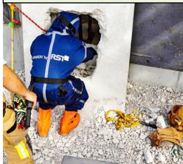
倒壊建物・瓦礫への進入
